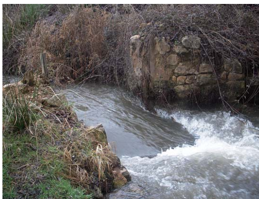
Foto 11: Azud Acequia de las Compuertas, actualmente en ruinas. Se propone su eliminación
