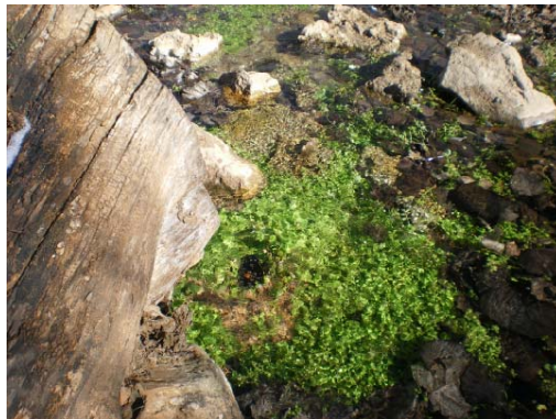
Foto 12: Surgencia de agua en el nacimiento del Jardín (pk 1+000)
